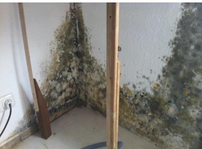
Massiver Schimmelschaden hinter einer ausgebauten Küchenzeile
